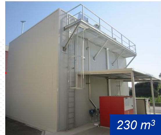
Línea lodos EDAR municipal Guillarei (Tui, Pontevedra)
